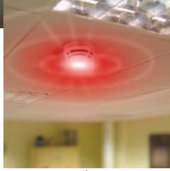
+ Yangın Algılama ve Alarm Sistemleri
